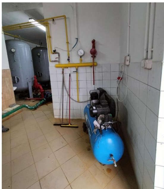
Układ przygotowania powietrza technologicznego
