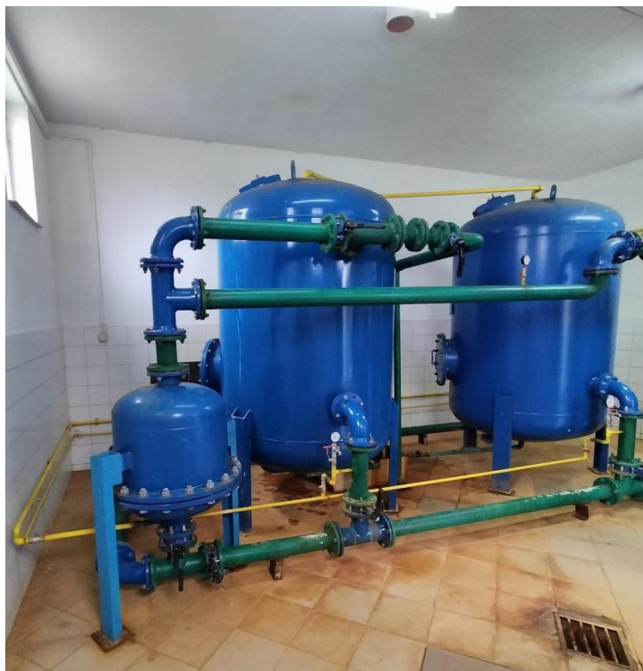
Istniejące filtry ciśnieniowe
