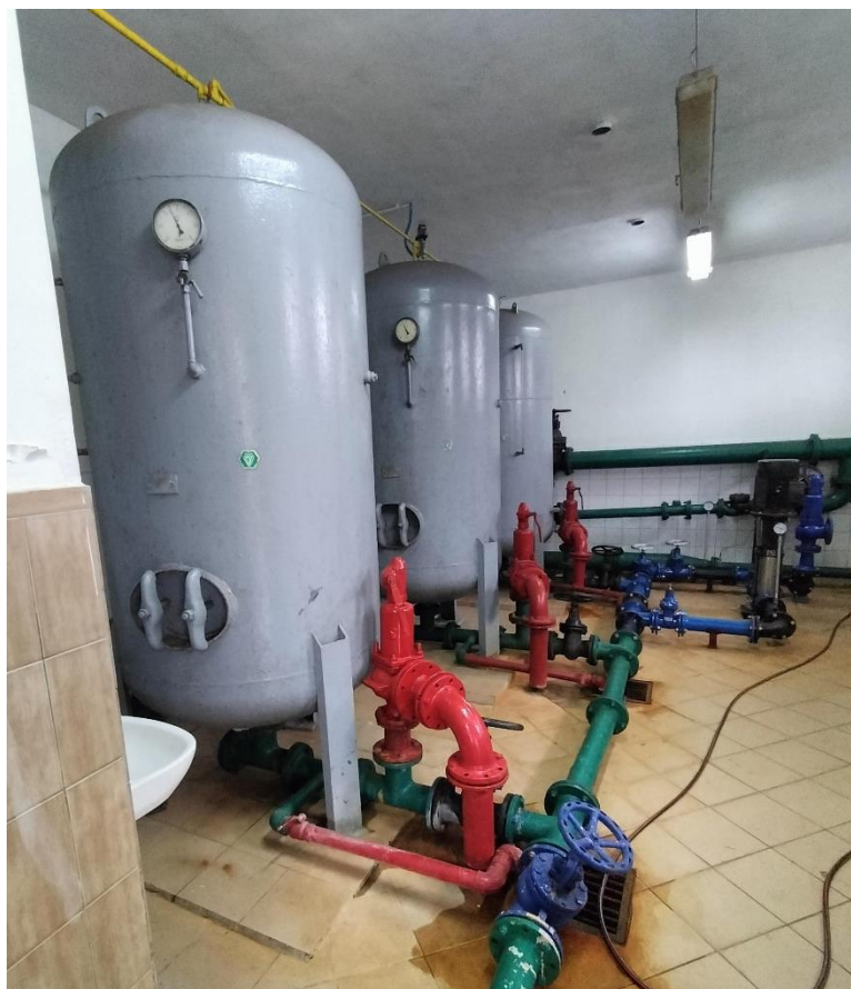
Istniejące zbiorniki hydroforowe
